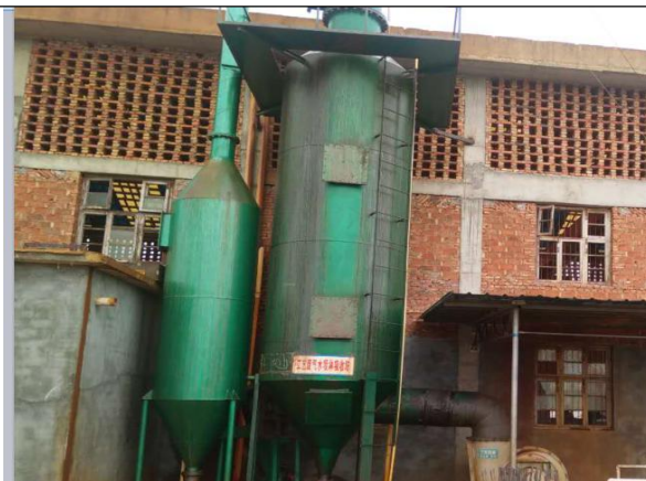
新建废气处理设施(左)
