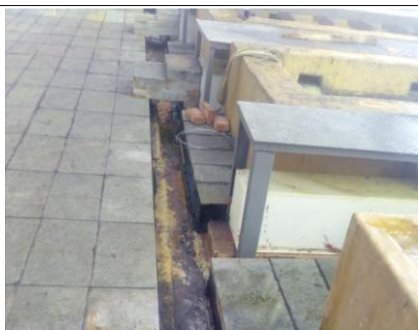
车间废水导流沟
