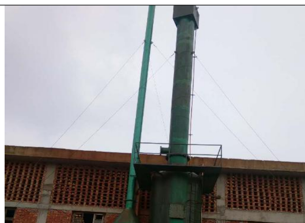
新建废气处理设施排气筒（左）
