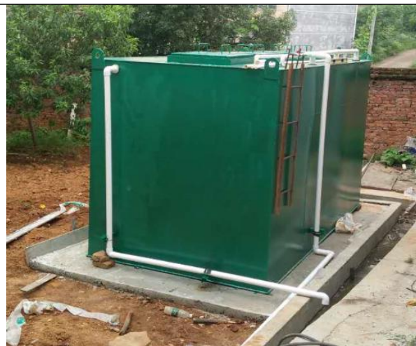
新建污水处理装置
