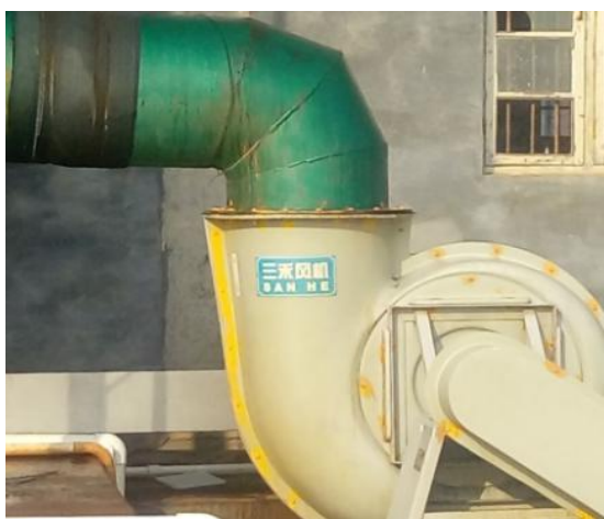
废气处理设施引风机
