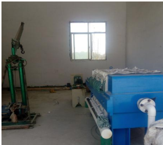
污水站设备房
