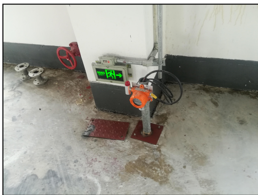
生产车间气体防泄漏检测仪器
