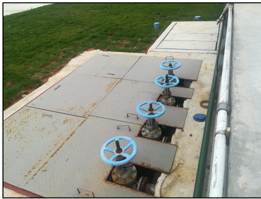
围堰内废水排放阀门
