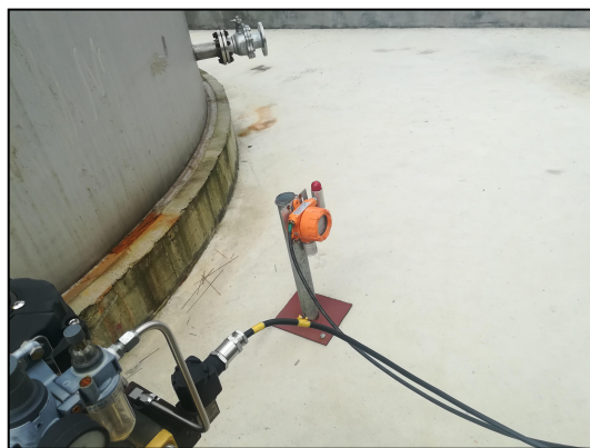
罐区气体防泄漏检测仪器
