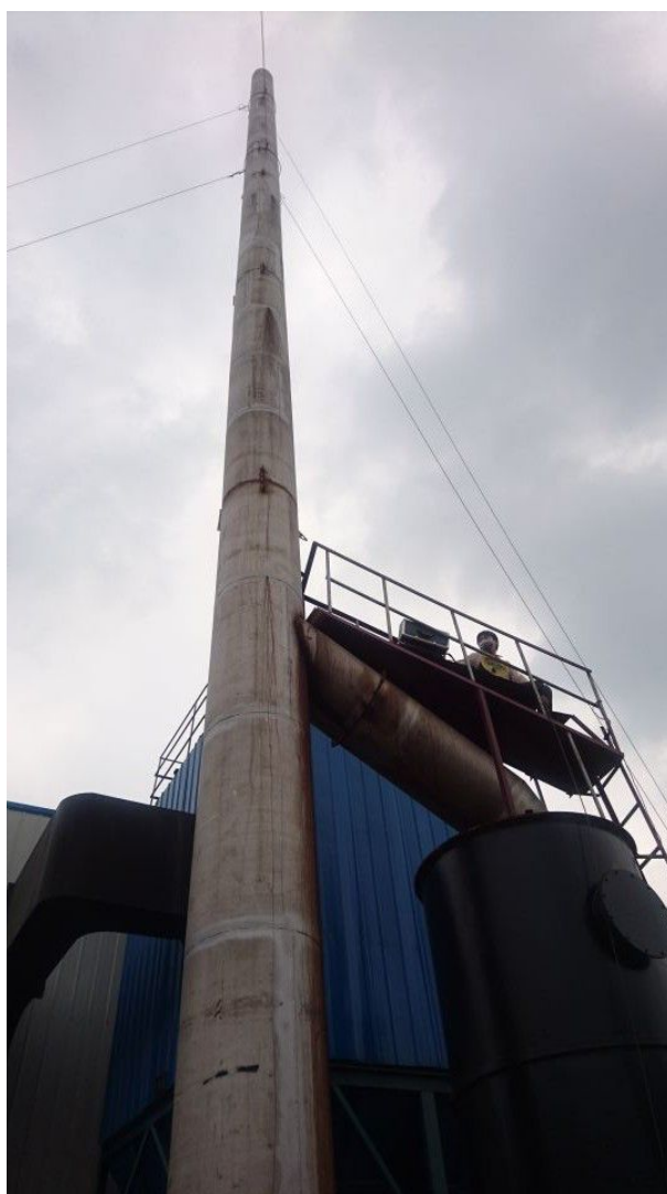
12t 燃煤锅炉
