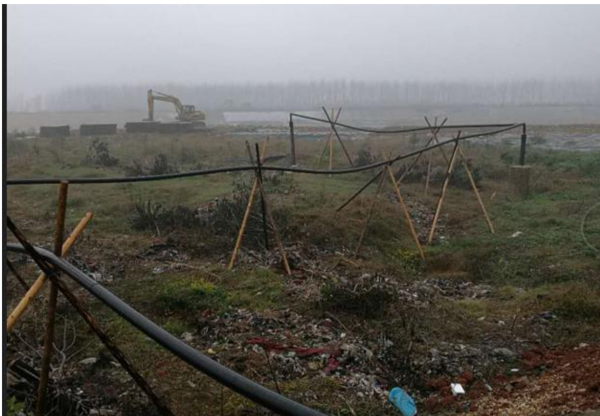
甲烷收集管道
