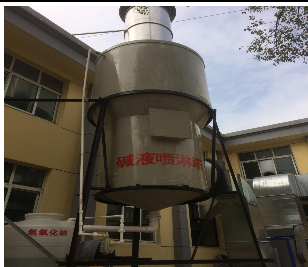
废气处理碱液喷淋塔
