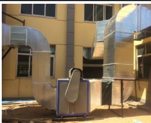
废气处理系统风机
