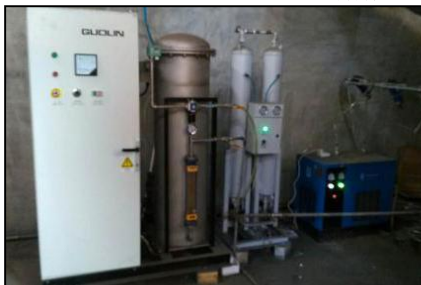
滚筒干燥除臭装置
