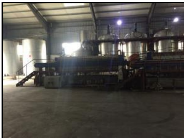
压滤机及储罐
