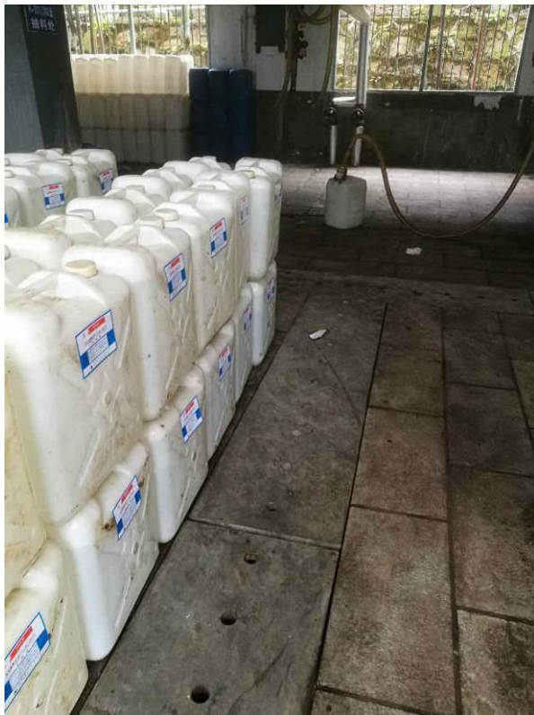
精细车间（地漏沟）
