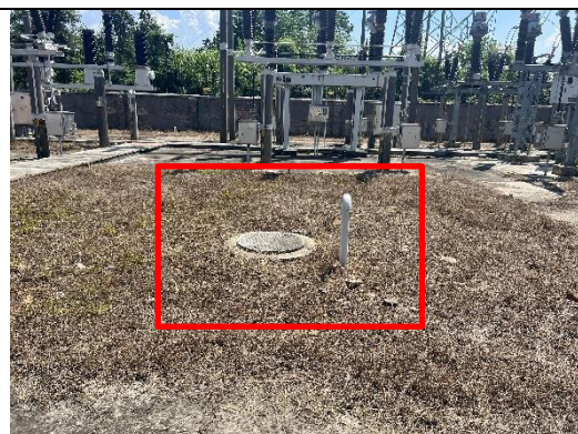
站内事故油池
