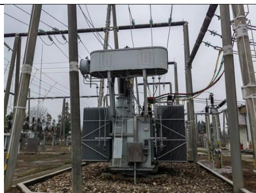
变电站站内 2#主变
