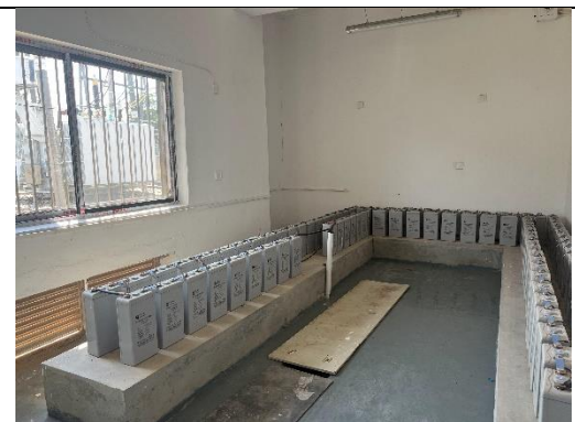
站内铅蓄电池
