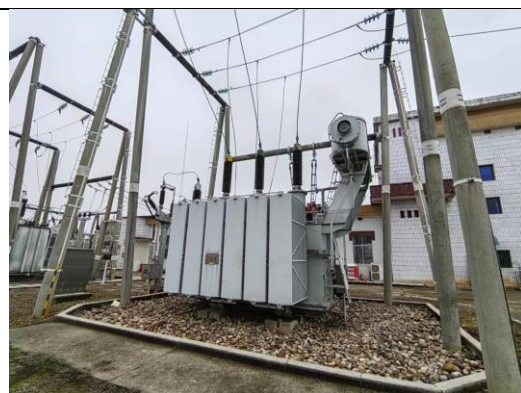
变电站站内#1 主变
