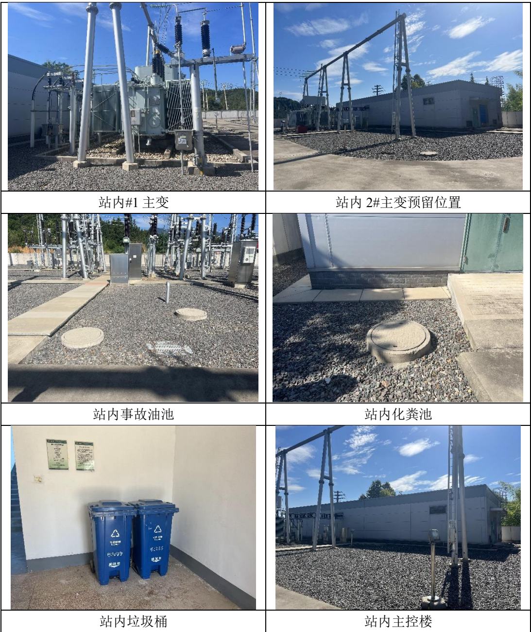
图 1 凤形 110kV 变电站站内环境现状
