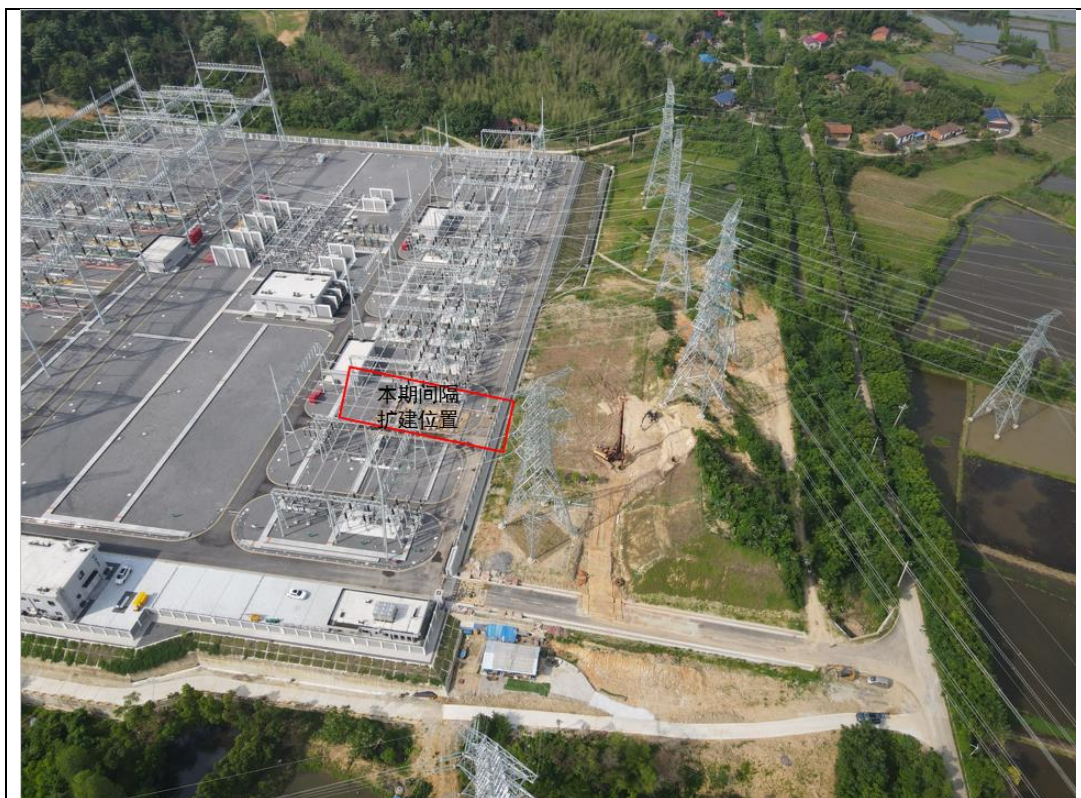
洞庭 500kV 变电站 220kV 间隔出线侧环境现状
