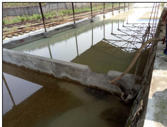
渗沥水回收池
