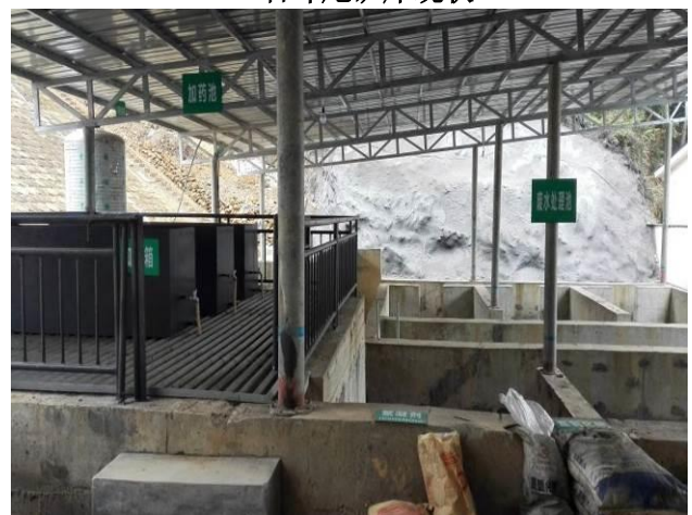
石坪尾矿库坝下废水处理站
