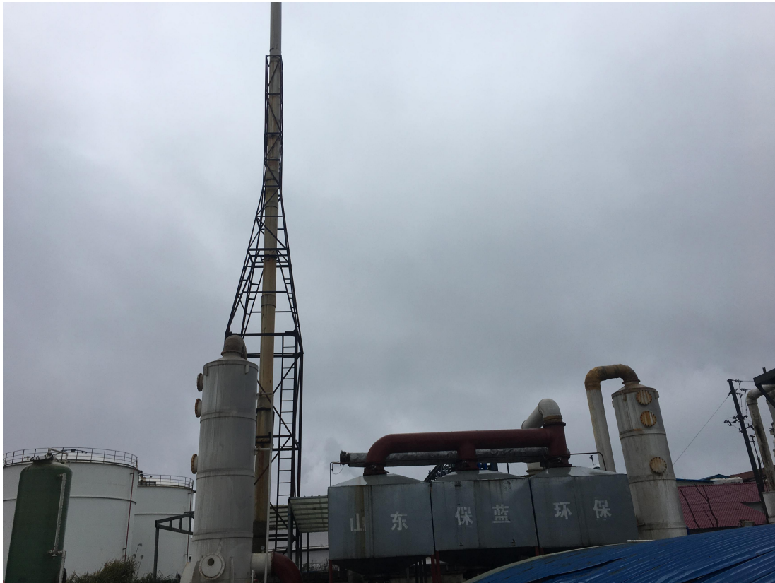
图 3.4 2018 年 6 月改造后的废气处理设施“碱液喷淋+吸附脱附+催化分解+碱液喷淋”
