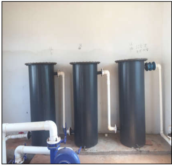
沼气干法脱硫装置
