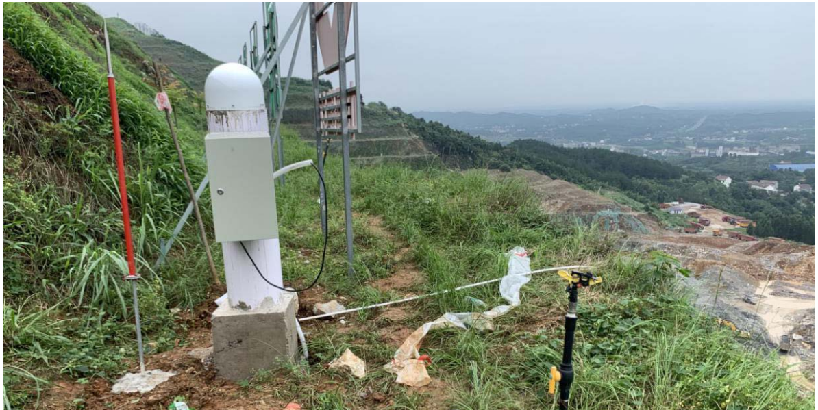
插图 4-3-11 露采场边坡的在线监测设备
